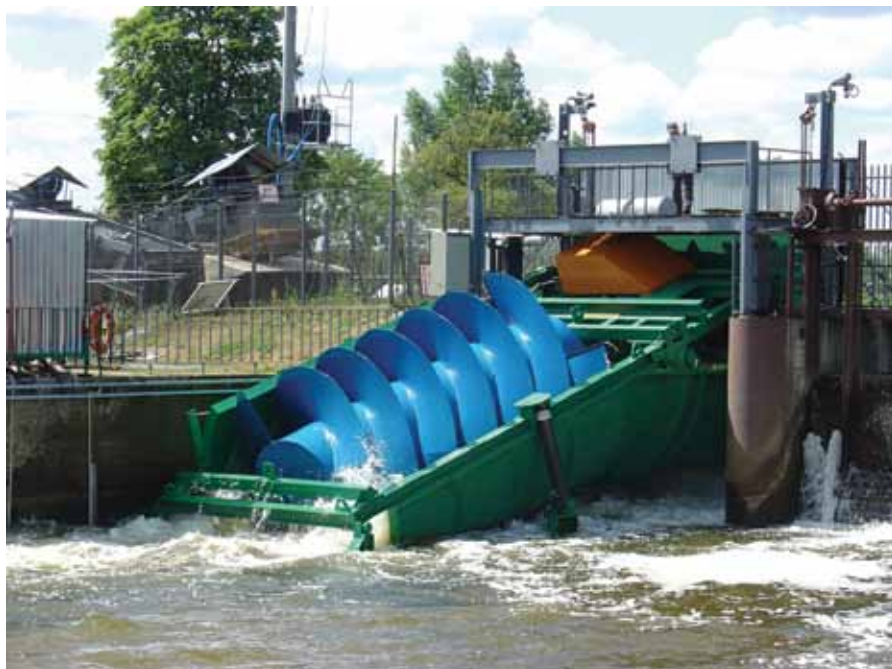
Fot.4. Mała elektrownia wodna na rzece Radomka woj. mazowieckie.
