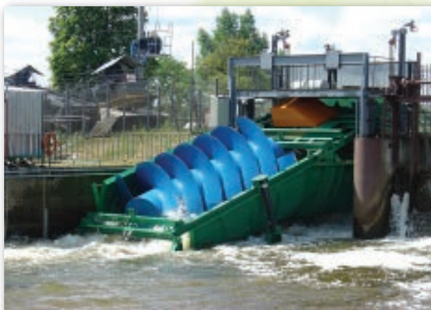
Fot.16. Mała elektrownia wodna w Goryniu na rzece Radomka, woj. mazowieckie, o mocy 80 kW
