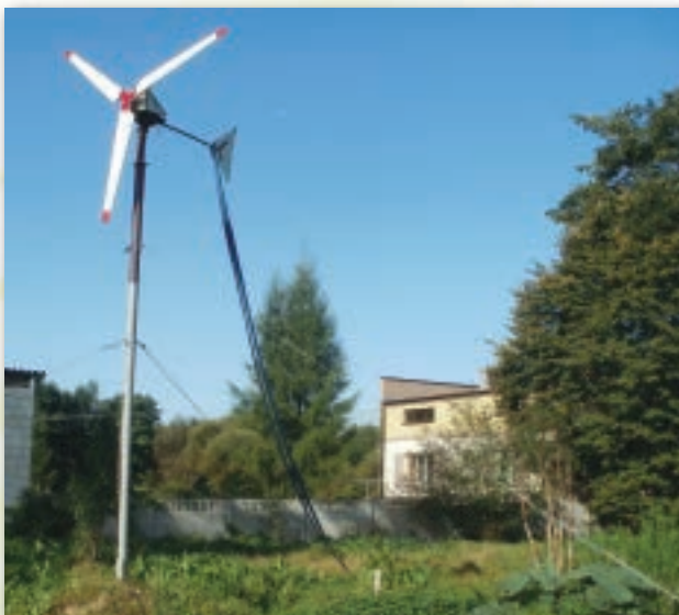
Fot.14. Mała elektrownia wiatrowa o poziomej osi obrotu w gospodarstwie rolnym, woj. mazowieckie
