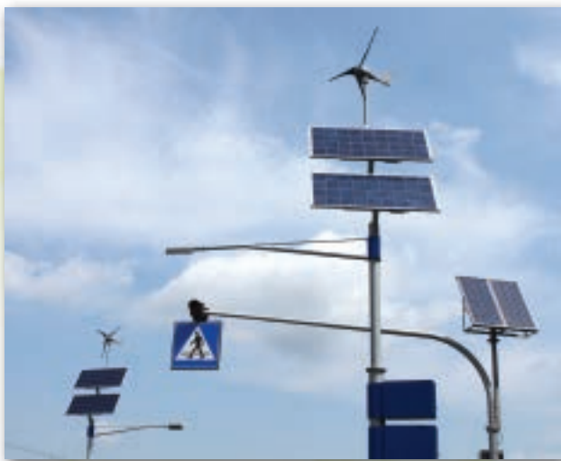
Fot. 12. Panele fotowoltaiczne zintegrowane z małymi turbinami wiatrowymi służące do zasilania sygnalizacji świetlnej na drodze w woj. mazowieckim
