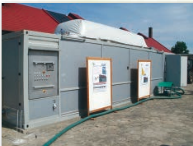
Fot.8. Kontenerowa mikrobiogazownia ITP. Poznań
